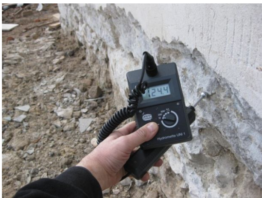
Fot.3,4 Wysoki wskaźnik wilgoci na zewnętrznej powierzchni muru, powyżej poziomu gruntu
