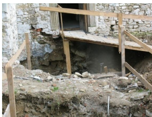
Fot.2 Ściana fundamentowa o nieregularnej, zewnętrznej powierzchni
