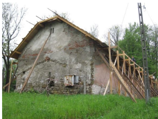
Fot.1 Ściana południowa naprawiana tynkiem na wysokości z dużą ilością cementu (ściana kamienna)
